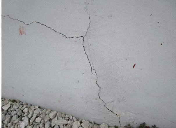
Sprickor i sockelns puts
